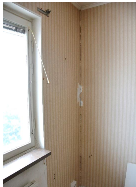
Sprickbildning som även syns interiört. Vlm-kmvcm-0886
